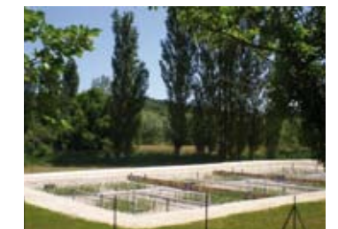
Station d'épuration adaptée aux collectivités rurales (filtre planté de roseaux) - Labastide de Virac
