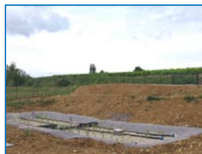
Station d'épuration à filtres plantés de roseaux - hameau de Sauveplantade (Rochecolombe)
